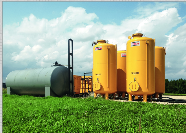
Abb. 1: Flughafen Bayern, Mobile GW-Reinigungsanlage für PFC, Q w = 10-30 m 3 /h
