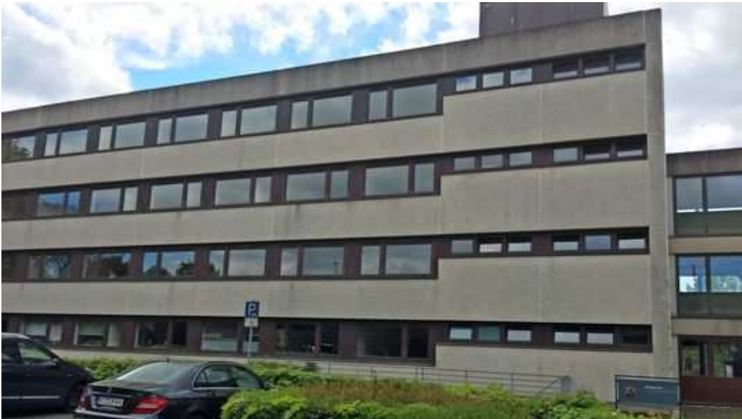
Sanierungsbedürftig: Das Amtsgericht Bitburg. FOTO: Ulrike Löhnertz / tv
